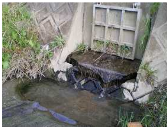
写真-2 アンモニア性窒素濃度が高かった水門
