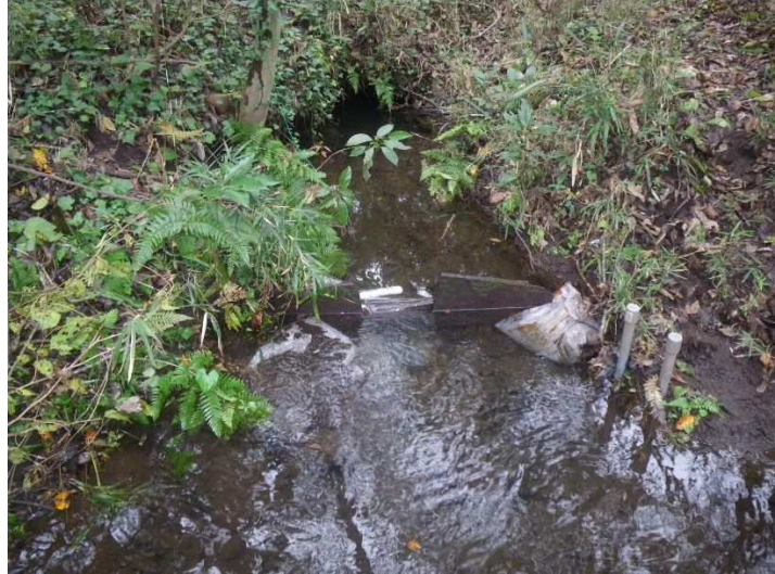
写真2 これまで見たことが無いほどの流量の湧水です。流されていた堰、土嚢、ログを仮復旧しました。後日、改めて修復する必要があります。
