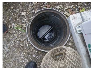
青年館敷地内にある雨水浸透枡を観察しました。
