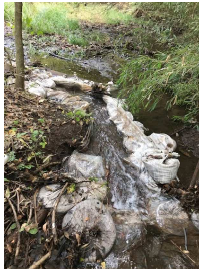
写真4 実験水路では土嚢が流され、途中のビニールを突き破り越水していました。
