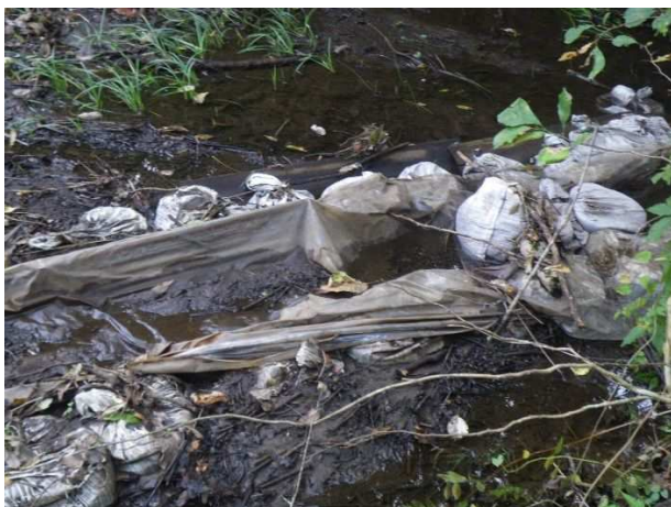
写真6 土嚢が流され水路を堰き止めていました。
